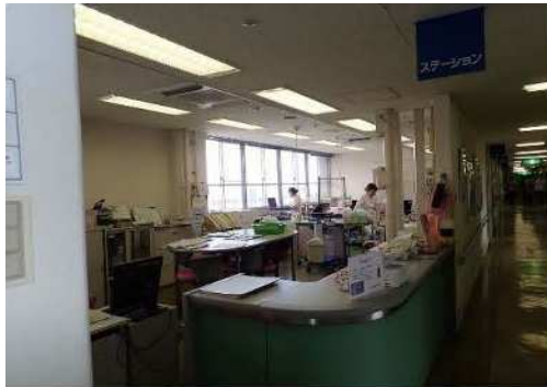
① ナースステーション蛍光灯（改修前）
